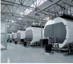
Moderne industrielle Wärmeversorgungssysteme Modern industrial heat supply systems
