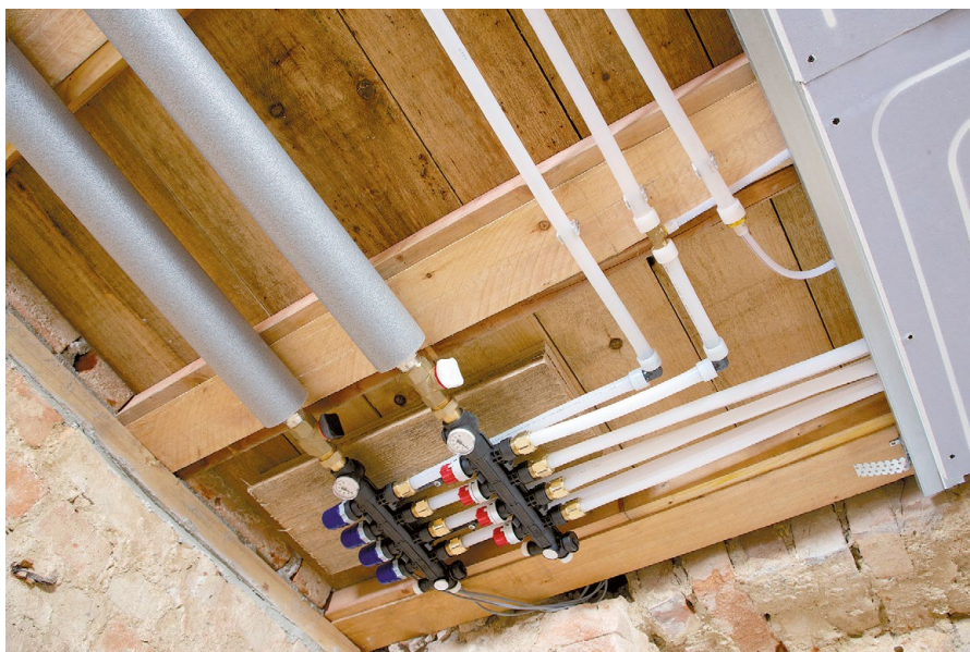
Abbildung 2: Heiz-/Kühlkreisverteiler an Decke; Quelle: BDH
