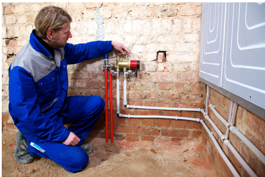
Abbildung 4: Montagesituation eines dezentralen Heiz-/Kühlkreisverteilers inkl. Umwälzpumpe an einer Wandfläche in der Erweiterung einer bestehenden Wärmeübergabe im Bestand; Quelle: BDH
