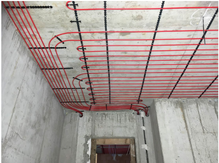
Abbildung 6: Montage der Nassweise an der Decke eines Neubaus mit Befestigungsschienen und Anbindelungen (durchlaufende Leitungen); Quelle: BDH
