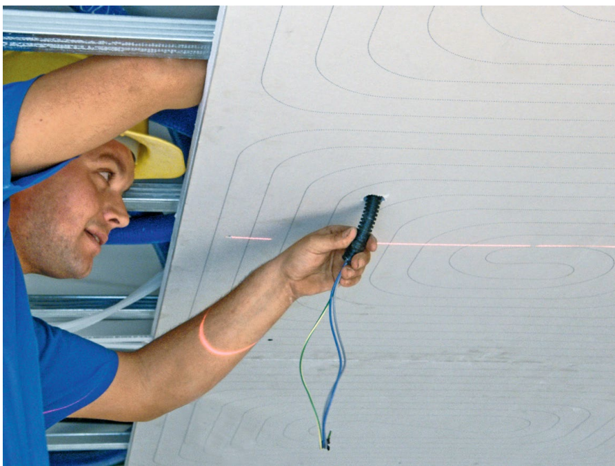
Abbildung 10: Montage der Modulbauweise an einer abgehängten Deckenflächen und Durchführung elektrischer Leitungen; Quelle: BDH
